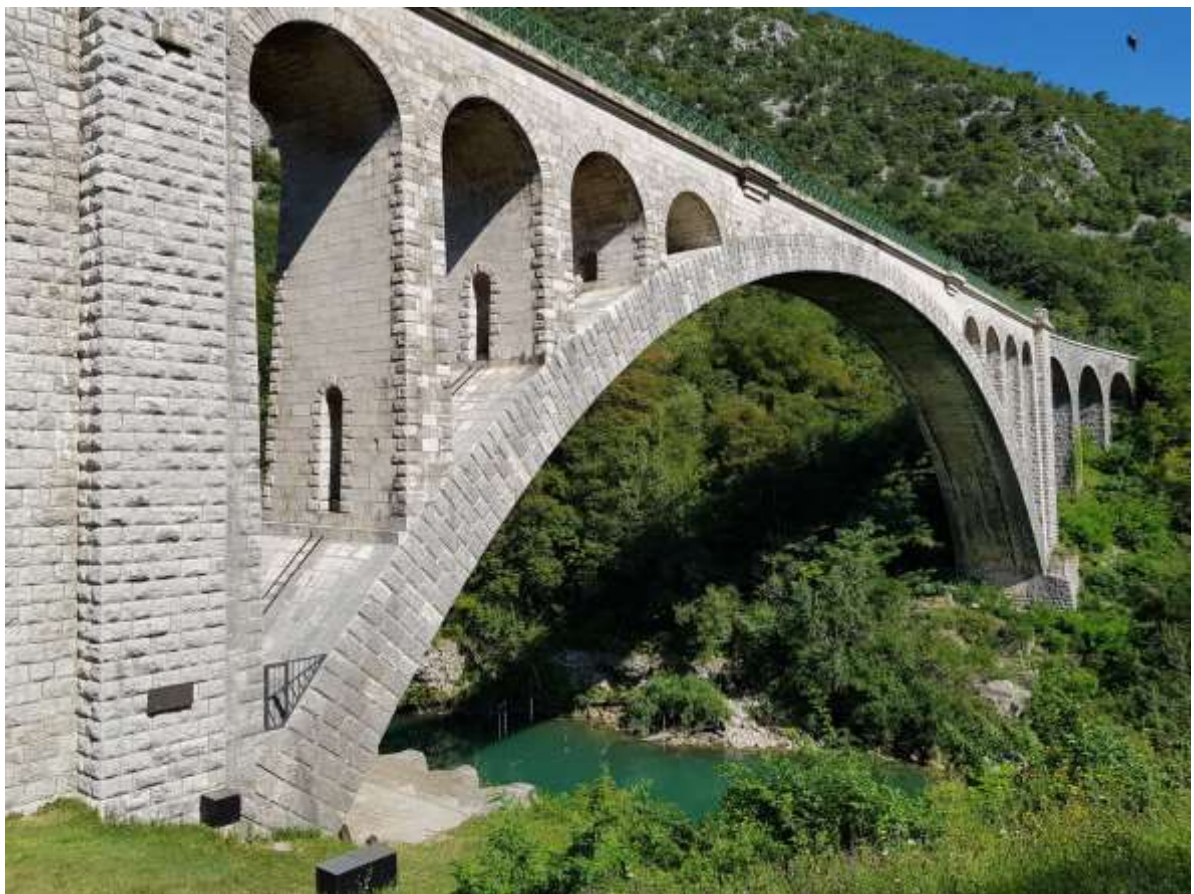
Slika 4: Solkanski železniški most iz leta 1906 je zgrajen iz nabrežinskega kamna. Most ima največji kamniti lok na svetu z razponom 85 m.
